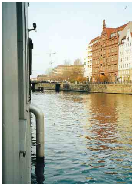
Überlauf des Regenspeichers in die Spree
