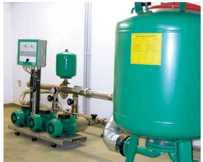
Regenwasser-Zentrale und zusätzlicher Druckausgleichsbehälter, 400 l, im Untergeschoss
