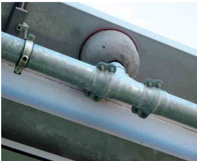
Druckströmungs-Entwässerung am Glasdach bringt das Regenwasser zu den Filtern
