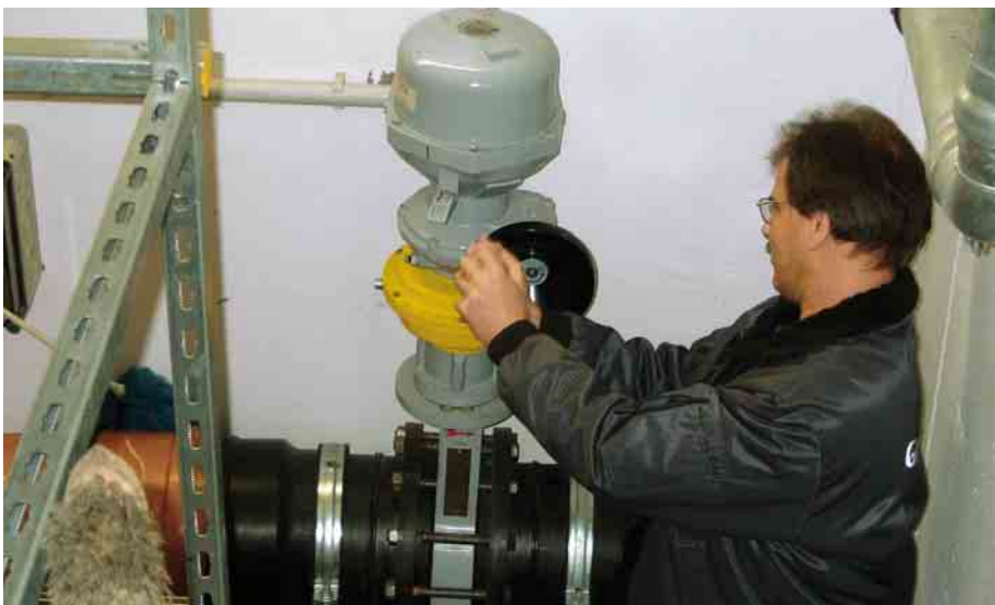
Motorklappe sperrt bei vollem Regenspeicher den Zulauf zur Zisterne, Bedienung von Hand möglich
