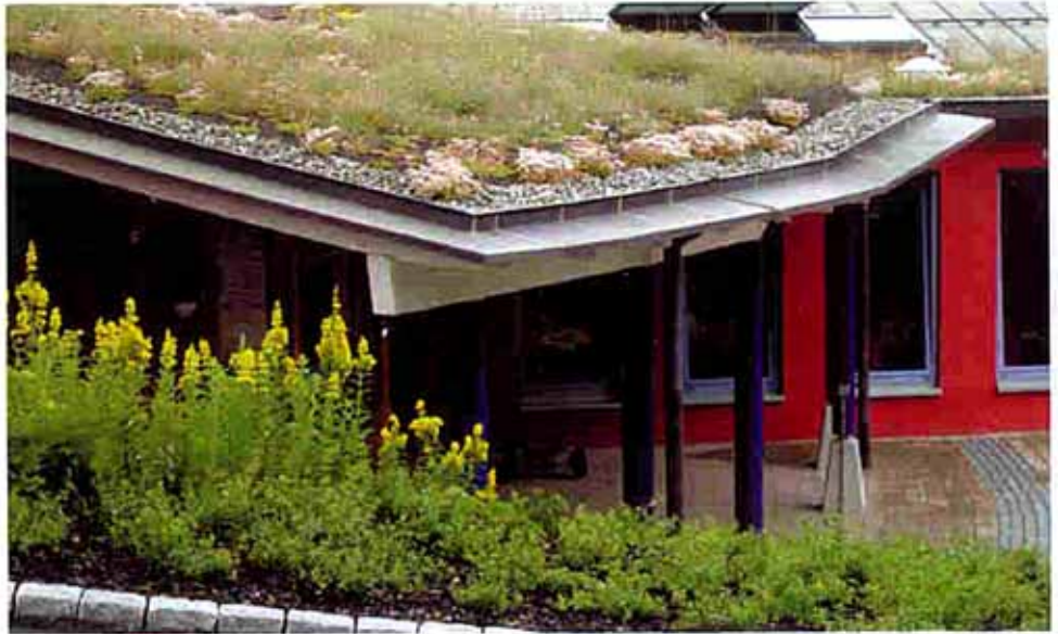
Wichtige Komponente der Regenwasserbewirtschaftung: Die Dachbegrünung wurde von der GaLaBau-Firma Paul Saum aus Hohenfels-Liggensdorf ausgeführt.
