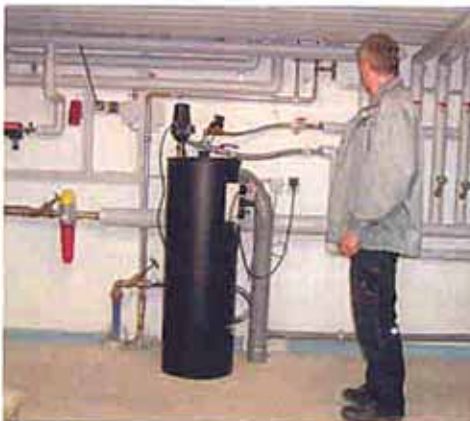
Die Versorgungsstation für das Betriebswasser im Werkstufengebäude wird ebenfalls von der Zisterne versorgt. | Foto: WISY AG.
